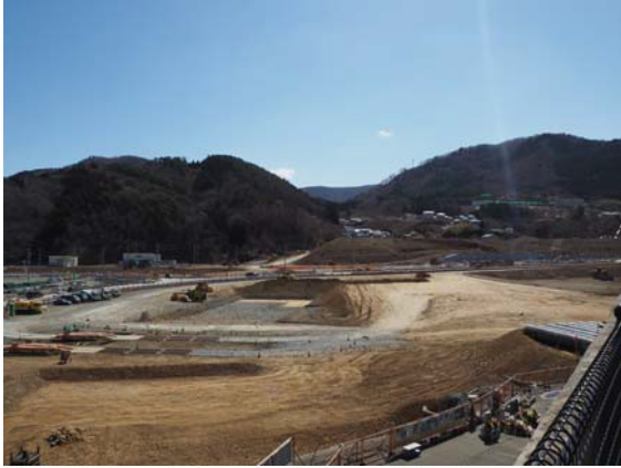
写真16 高台の病院駐車場から見たところ
