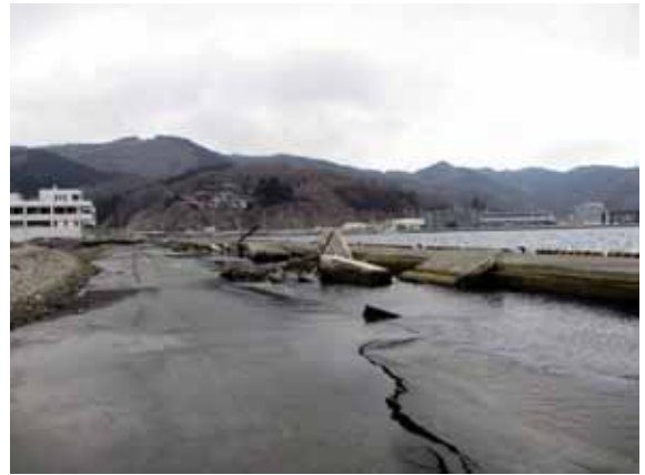
岸壁付近の陥没
