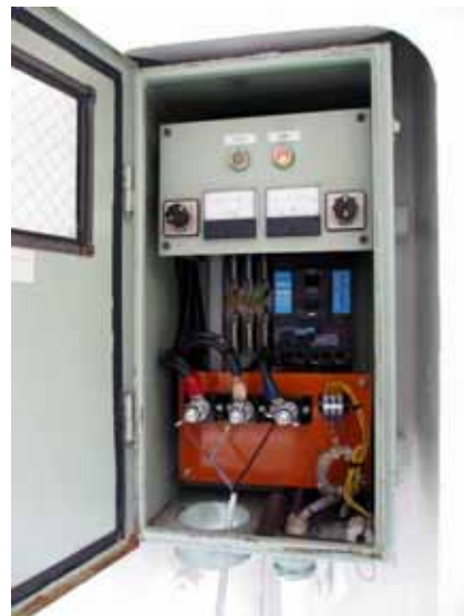
陸上電源接続箱から船内発電電力の取り出し
