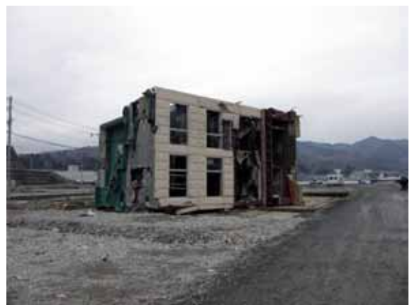
横倒しになって放置された軽量鉄骨造の建物
