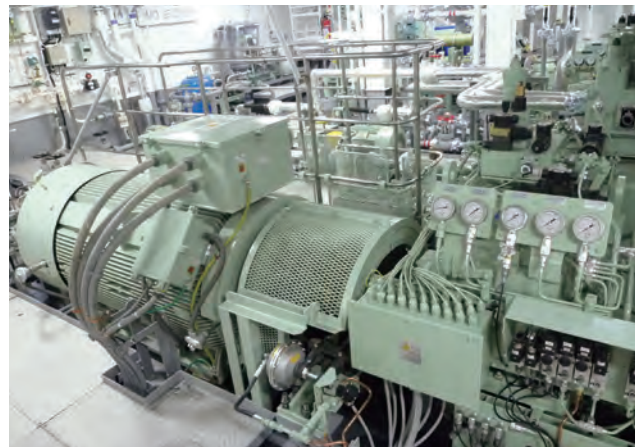
推進電動機 Propulsion motor
