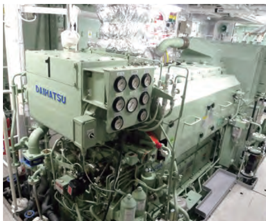
主発電機関 Main Generator Engine
