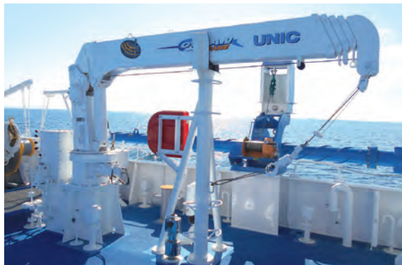
雑用クレーン Misc. Crane
