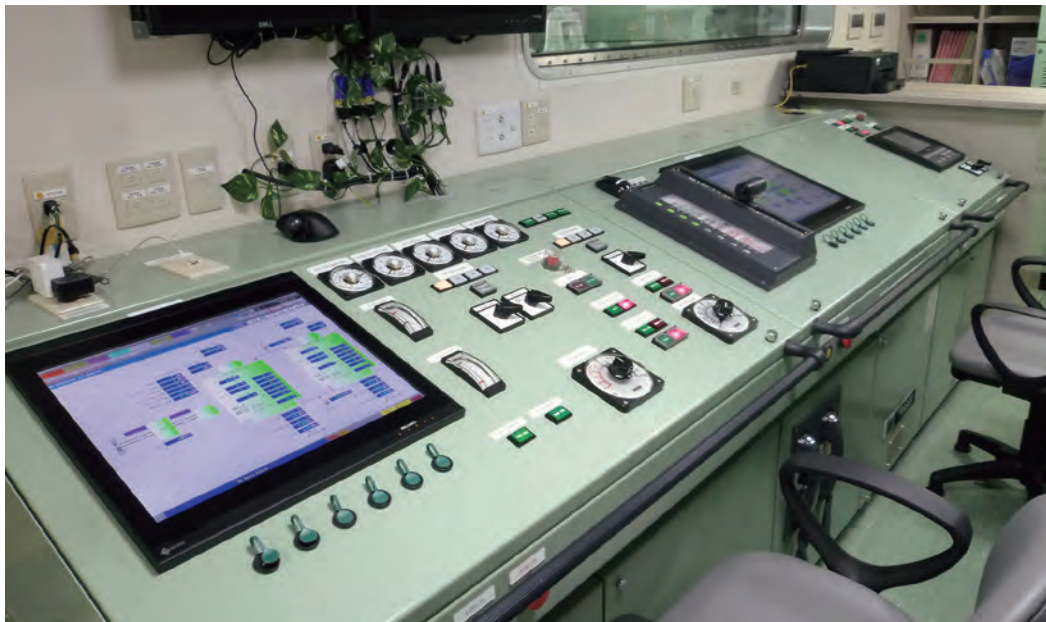
機関制御室制御盤
